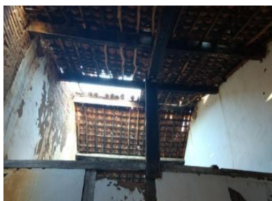
Figura 7 – Telhado com estrutura de madeira e telhas de barro Fonte: Acervo Pessoal (2017).
