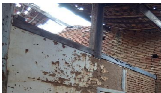
Figura 17 – Estrutura do Telhado em madeira com telhas de barro Canal Fonte: Acervo Pessoal (2017).
